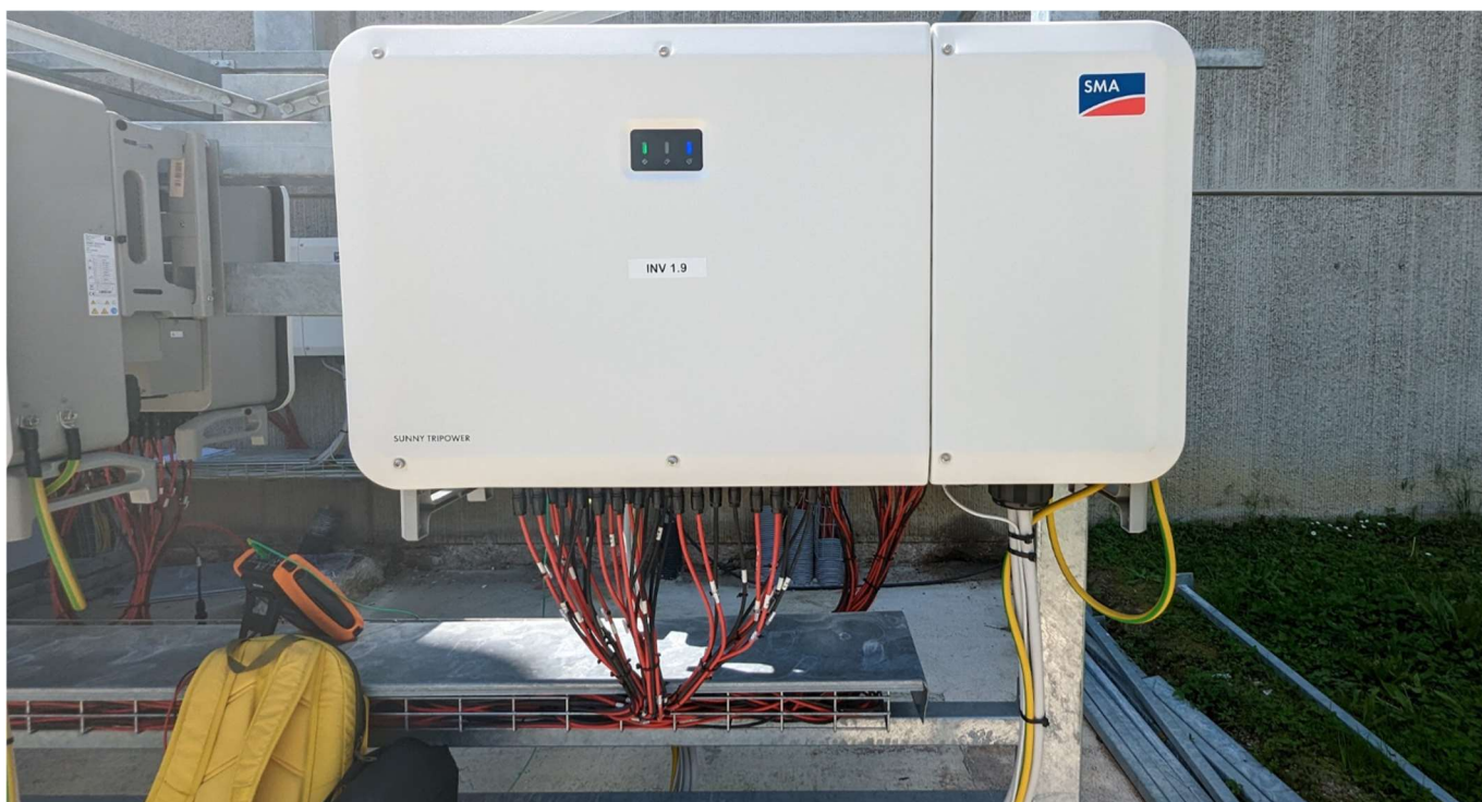
FIGURA 5: INVERTER IN FUNZIONE
