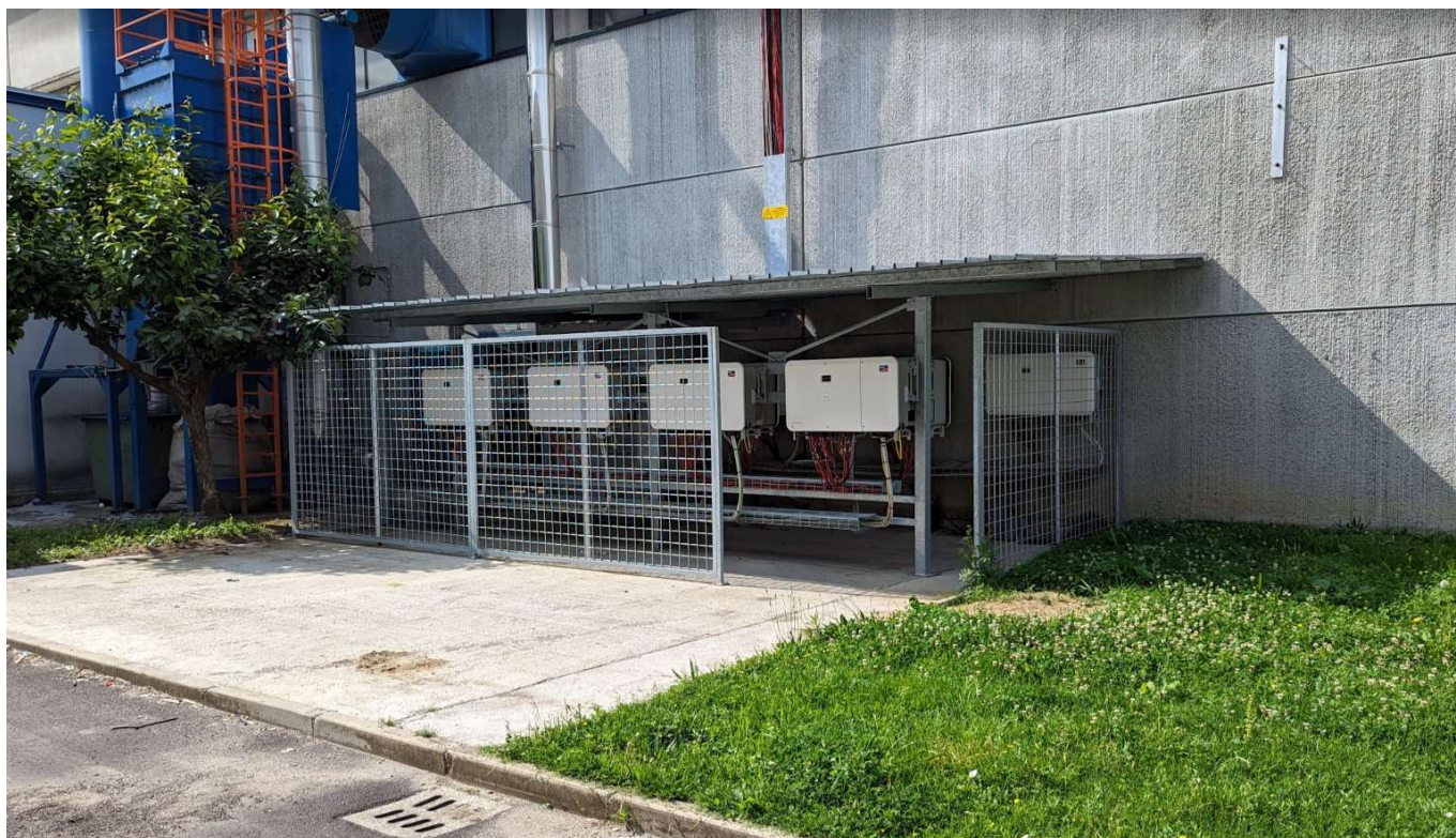
FIGURA 4: VISTA AREA INVERTER
